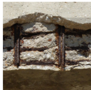
(b) 钢筋锈蚀
